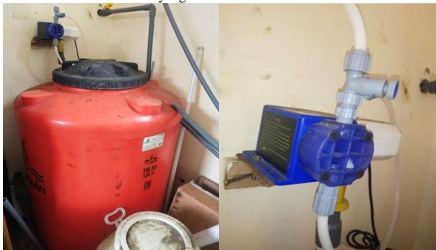
Gambar 8 Tangki dan Pompa Clorine
