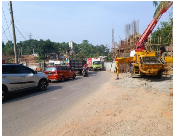
Gambar Antrian Kendaraan di Pintu Perlintasan JPL107 Bantaian Dari Arah Muara Enim Saat Menjelang Siang Hari (Saat Konstruksi Flyover , Agustus 2023)
