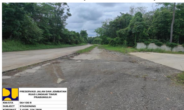
Gambar 3. Sta 06+100 s/d 07+100 jenis kerusakan jalan gelombang (Bleeding) dan cara perbaikannya di lakukan pembongkaran aspal dan beton lama diganti dengan beton baru setebal 30 cm dibawahnya dikasih Lantai kerja setebal 10 cm.
