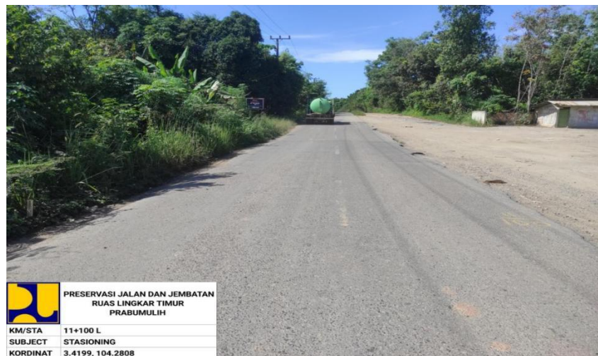
Gambar 7. Sta 11+100 s/d 12+100 jenis kerusakan jalan yaitu lapis aspal lama yang sudah aus dan akan diganti dengan beton baru cara perbaikannya di lakukan pembongkaran aspal dan beton lama diganti dengan beton baru setebal 30 cm dibawahnya dikasih Lantai kerja setebal 10 cm.
