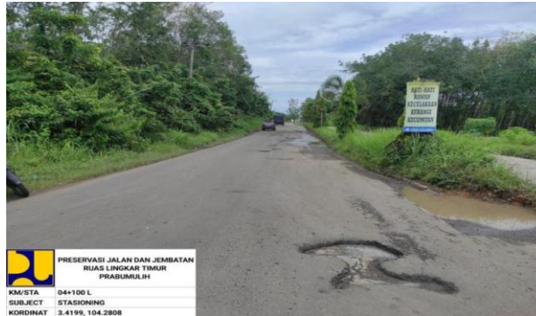
Gambar 1. Sta 04+100 s/d 05+100 jenis kerusakan jalan berlobang dan cara perbaikannya di lakukan pembongkaran aspal dan beton lama diganti dengan beton baru setebal 30 cm dibawahnya dikasih Lantai kerja setebal 10 cm.
