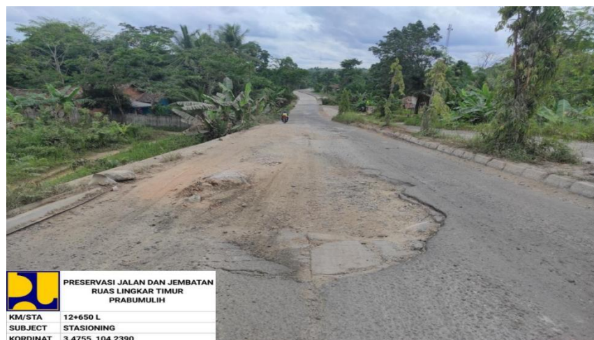
Gambar 8. Sta 12+100 s/d 13+100 jenis kerusakan jalan yaitu gelombang (Bleeding), cara perbaikannya di lakukan pembongkaran aspal dan beton lama diganti dengan beton baru setebal 30 cm dibawahnya dikasih Lantai kerja setebal 10 cm.
