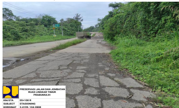
Gambar 2. Sta 05+100 s/d 06+100 jenis kerusakan jalan retak retak (craking) dan cara perbaikannya di lakukan pembongkaran aspal dan beton lama diganti dengan beton baru setebal 30 cm dibawahnya dikasih Lantai kerja setebal 10 cm.
