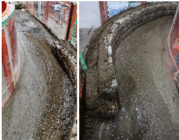
Gambar 4. Bronjong turun di bagian hilir (dilihat dari hulu dan hilir)
