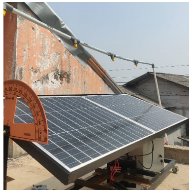
Gambar 1. Instalasi panel surya dengan sistem pendingin
