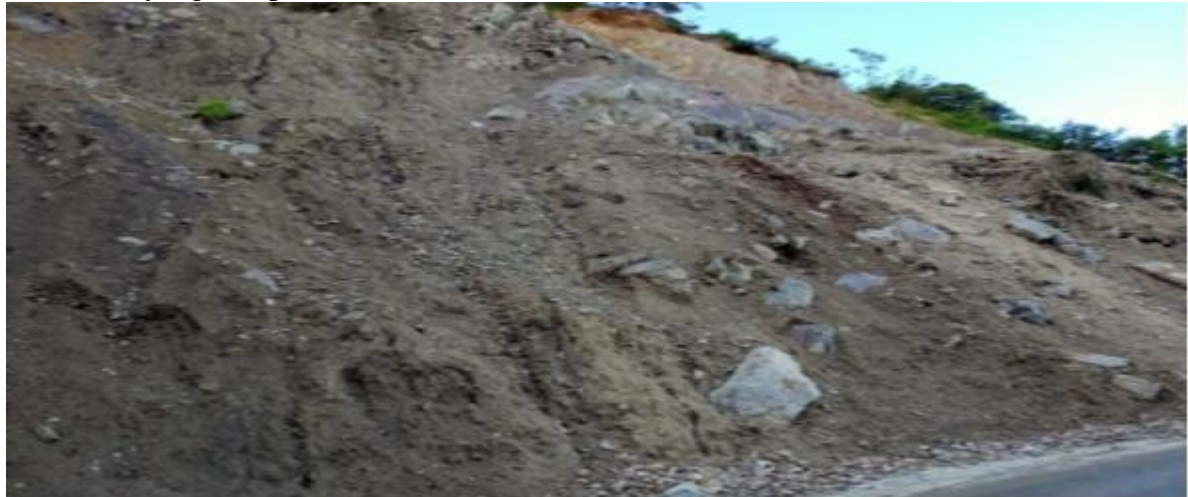
Gambar 1. Propil Lereng Tebing Setelah Keruntuhan
