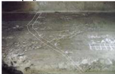
Gambar 4. Retak Melintang Balok 2-A-B
