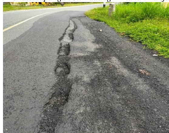
Gambar 4 Retak refleksi ( reflection cracks )
