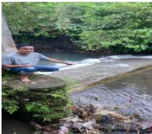
Kondisi Tumpukan Sedimen pada STA 201+400
