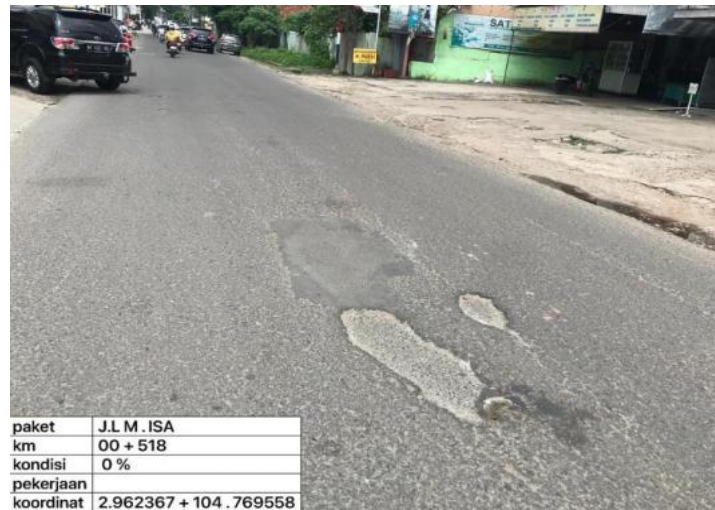
Gambar 1. Kondisi lubang sebelum dilakukan rehabilitasi
